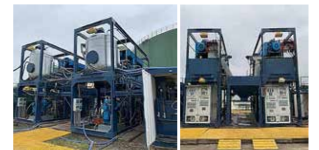
图6 现场减量化处理系统
